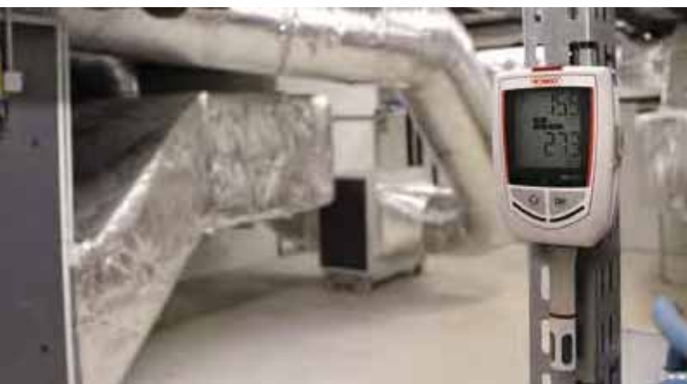
KH 220 fissato con magnete nella stanza climatizzata di un impianto industriale
